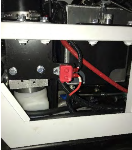
Cooling Fan Circuit Breaker
